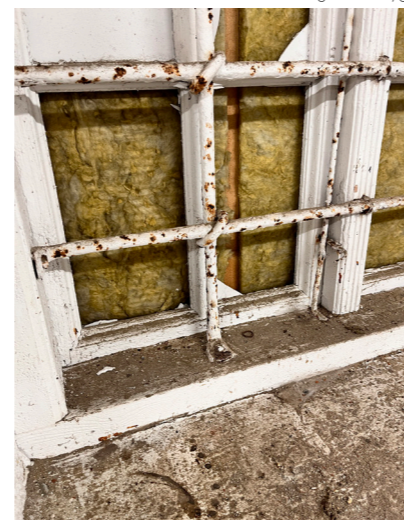
Gitter montert på innsiden av vinduer i plan U mot vest. Må antas å ha vært på alle vinduer plan U.
